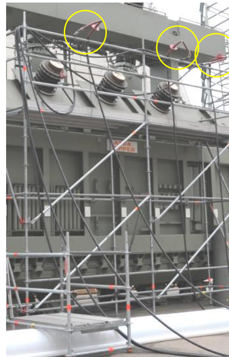
Подключение к трансформатору с низкой стороны
