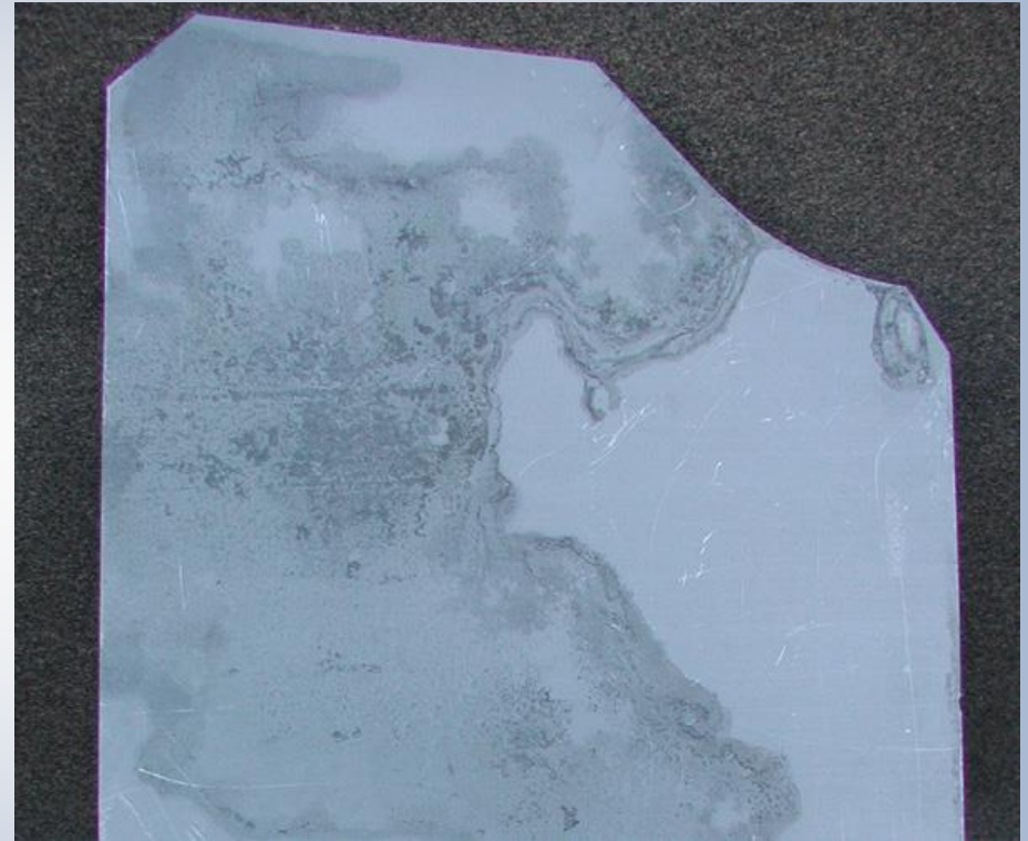
«Коррозия цинкового покрытия»
